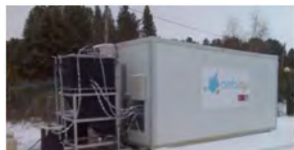
Figures a) ; b) Reactor IASB – 1ª referência à escala industrial (a) e unidade piloto (b) Reactor IASB – 1ª Industrial reference (a) and pilot plant (b)
